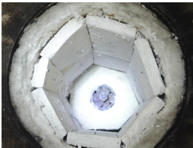
Figure 2- The thermal isolation of combustor inner wall شکل ۲- نمایی از پوشش عایق حرارتی دیواره داخلی محفظه
